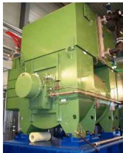
Die mit einem Ammoniak-Wasser-Gemisch angetriebene Turbine und der Generator des Geothermiekraftwerks Unterhaching.
