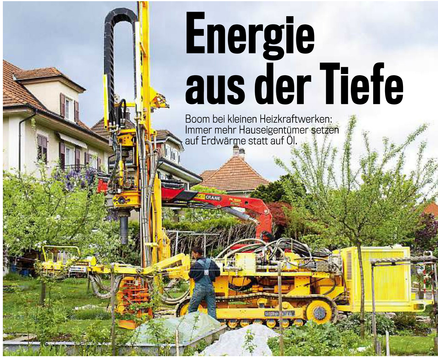
Installation der Erdwärmehheizung: Der Garten der Familie Gerster in Solothurn wurde letztes Jahr zum Bauplatz.
